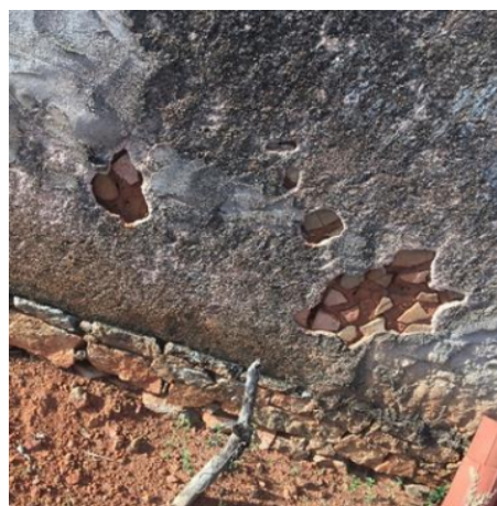
Figura 8 – Deslocamento do revestimento da (EDIF.6)
