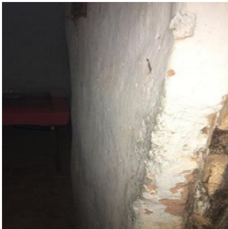
Figura 5 – Desnívelamento da parede da (EDIF.6)
