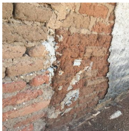
Figura 7 – Deslocamento do revestimento da (EDIF.2)
