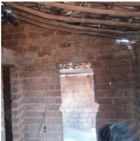
Figura 6 – Abaulamento do telhado da (EDIF.5)
